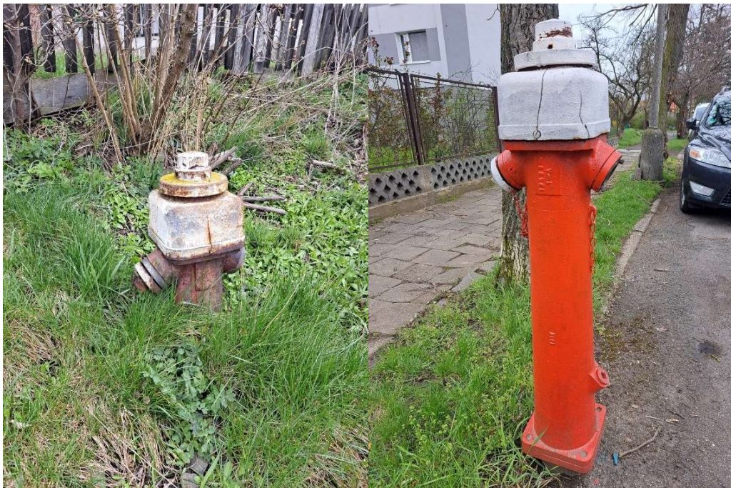
Obrázek 2 - Požární hydrant nalezený při fyzické obhlídce zdroje
