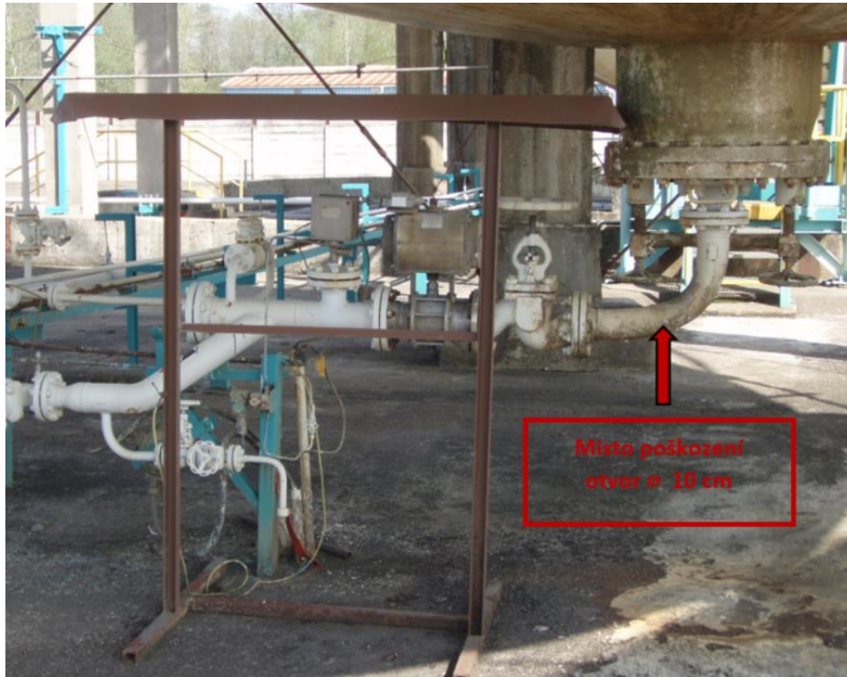
Obrázek 12 – místo poškozeného potrubí pod zásobníkem s propylenem
