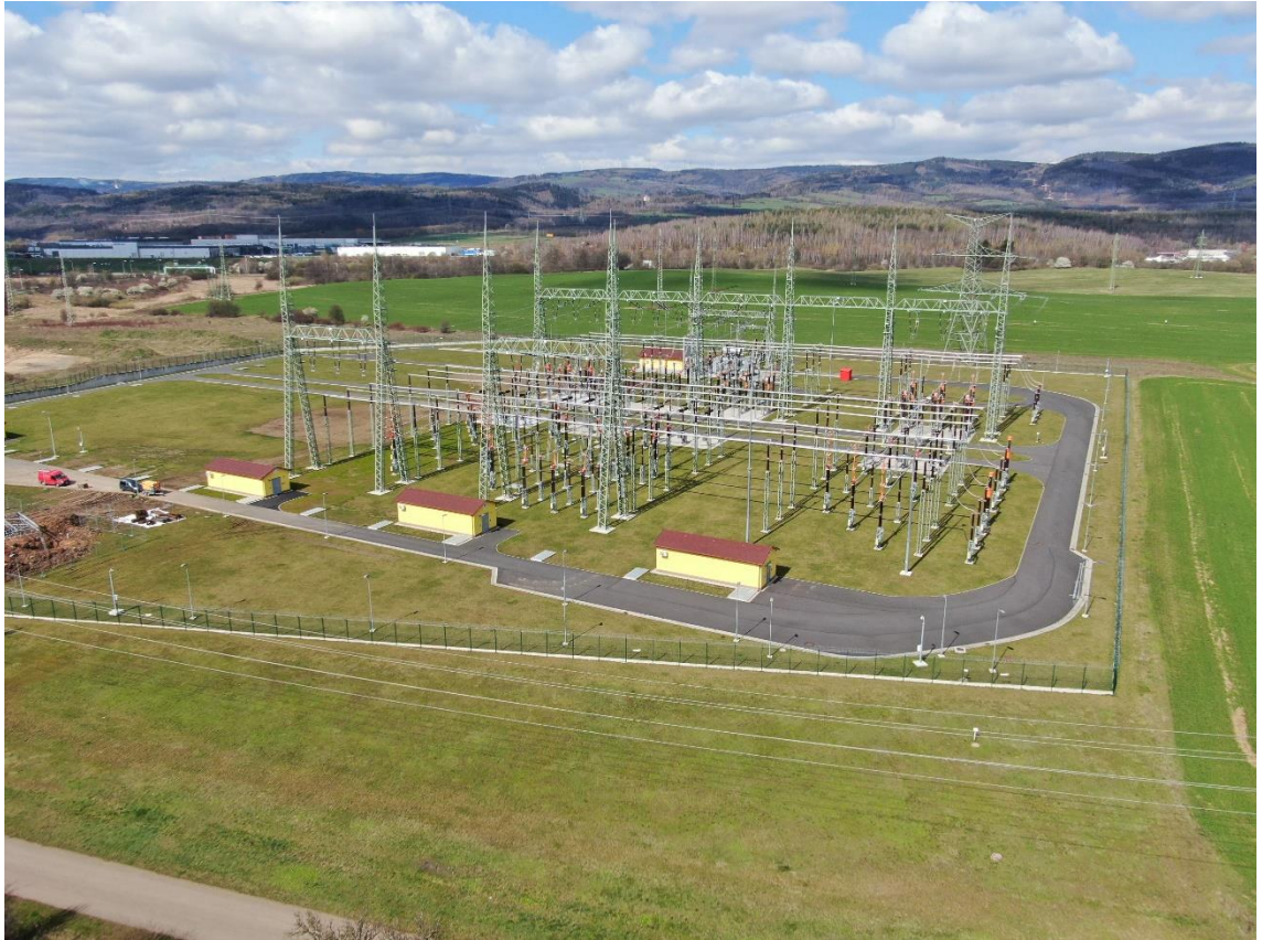
Obrázek 9 Rozvodna Verněřov, nová část [zdroj vlastní]
