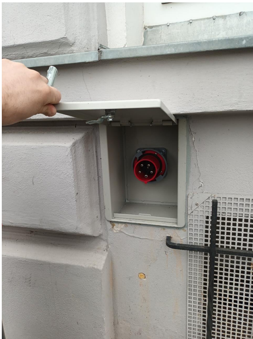
Obrázek 17 Připojný bod elektrické energie [zdroj vlastní]
