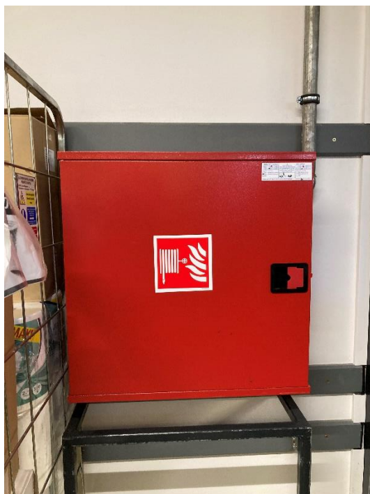
Obrázek 20 Nástěnný hydrant (zdroj: autor)
