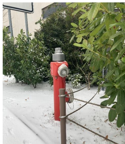
Obrázek 15 Nadzemní požární hydrant (zdroj: autor)
