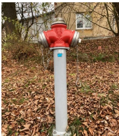
Obrázek 16 Nadzemní požární hydrant (zdroj: autor)
