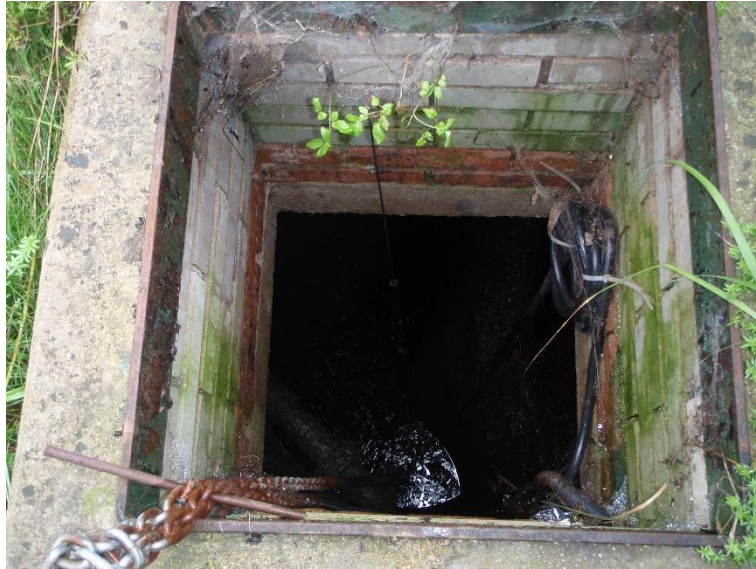
Obrázek 14 Uzavřená podzemní nádrž (zdroj: autor)
