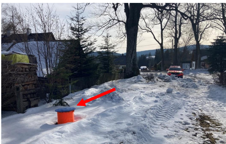
Obrázek 33 podzemní požární nádrž Rejvíz (zdroj: autor)
