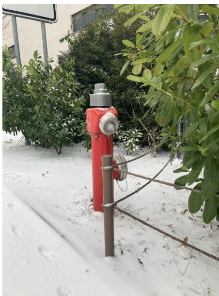
Obrázek 19 Požární výtokový stojan (zdroj: autor)
