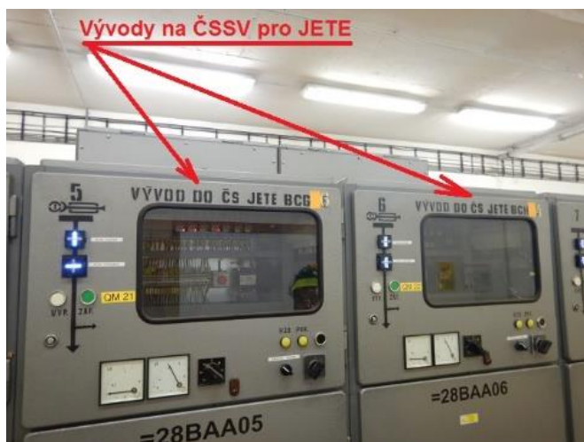
Obr. 7. V rozvodně RE vyznačeny vývody 6kV pro ruční manipulování vyvedení elektrického výkonu do PS (čerpací stanici Hněvkovice pro JETE).
