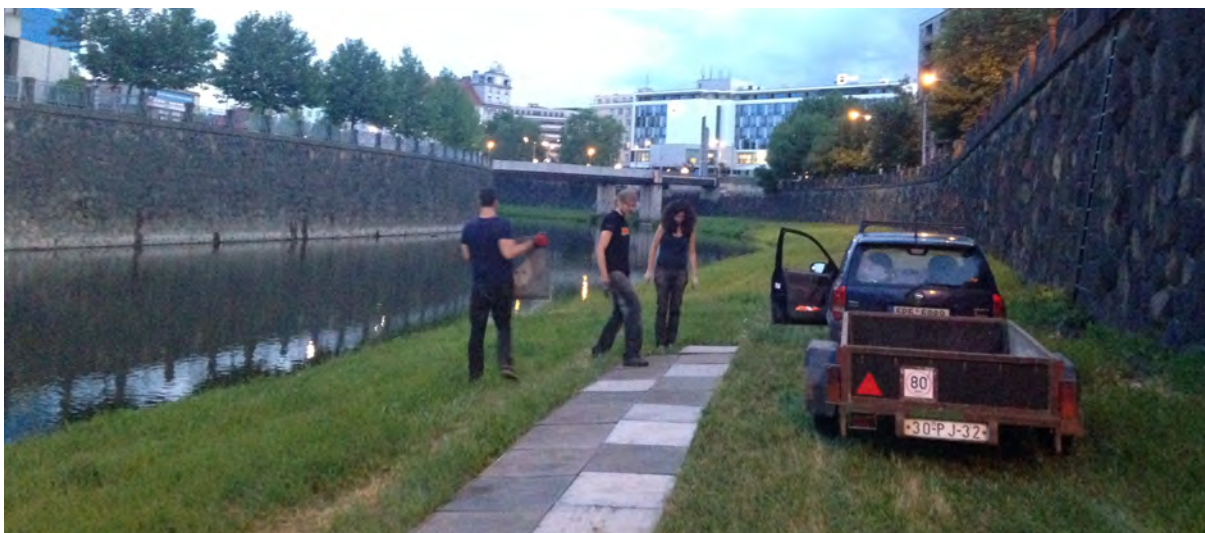
Obr.č.40: Stavba chodníku z replastových desek před zahájením festivalu Náplavka k světu. v roce 2016 v úseku Anglického nábřeží o délce cca 500m - jediná možnost dočasného zpřístupnění náplavky v centru města, autor: Boříková Hana
