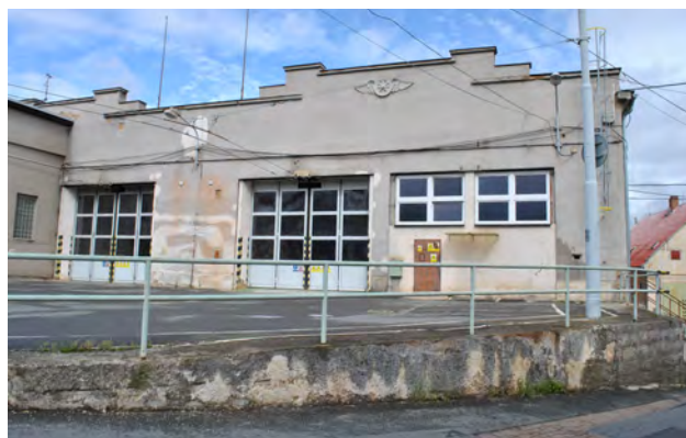
Obr.č.273: Současný stav objektu bývalé zámečnické dílny, foto: Boříková Hana
