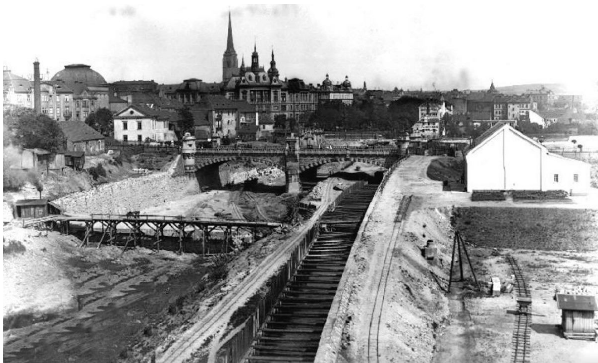
Obr.č.211: Výstavba nového Královského jezu a regulace řeky Radbuzy - v pozadí Wilsonův most (1920), zdroj: Archiv města Plzně
