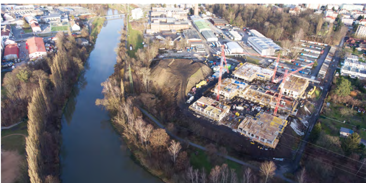
Obr.č.241: Pohled na výstavbu residenční části projektu Nová papírna (2022), foto: Boříková Hana
