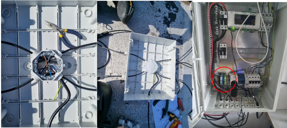
Obrázek 27: Zapojení modulů do svorkovnice (vlevo), rozvodná skříň (vpravo)
