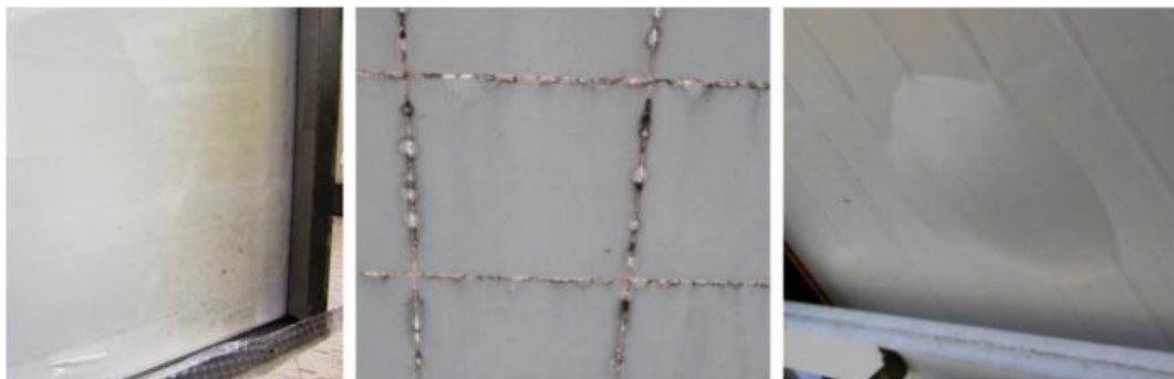
Obrázek 13: Příklady degradace: změna barvy (vlevo), praskání (uprostřed) a delaminace (vpravo), [1]
