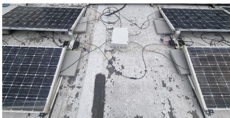
Obrázek 26: Zapojené moduly na střeše
