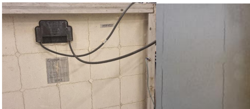
Obrázek 16: Typy trhlin v zadní desce: čtvercové trhliny pod meziprostory článků (vlevo), podélné trhliny umístěné pod tyčemi sběrníc (vpravo), [8]
