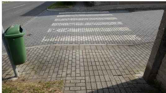
Obrázek 50 - Absence barevného zvýraznění prvků OOSPO na přechodu v ulici Zápšká (zdroj: autor)
