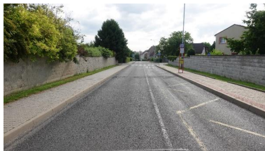
Obrázek 53 - Opatřebované VDZ V 1a, V 11a, absence VDZ V 4 v ulici Polabská (zdroj: autor)
