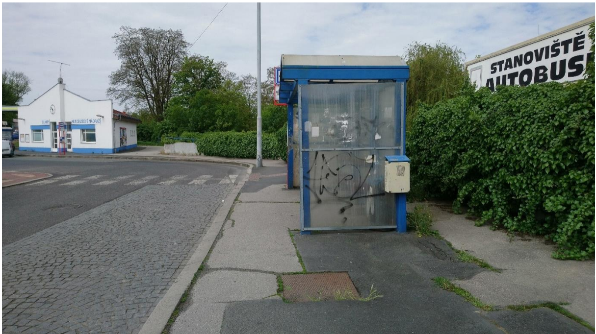
Obrázek 26: Neadekvátní povrch nástupiště u st. 3 (deficit č. 24). Patrné jsou také další nedostatky v provedení zastávky.
