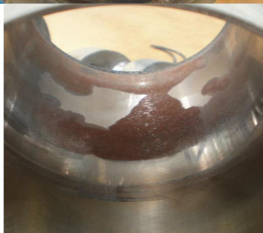
Obr. 18: Neodstranitelná vnitřní koroze [autor]
