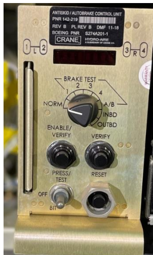
Obrázek 11 – Panel počítače systému Autobrake v elektronické šachtě/šachtě avioniky používaný pro diagnostiku systému a jeho nastavení, Zdroj: Autor
