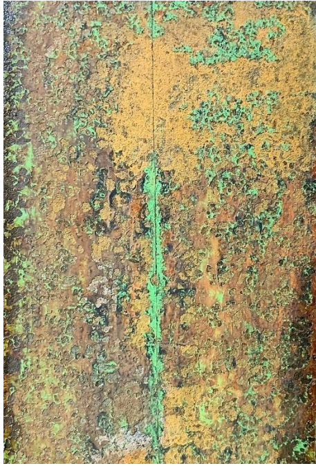
Obrázek 48: Vzorek HRK (4) pro hodnocení stupně delaminace [foto autora práce]
