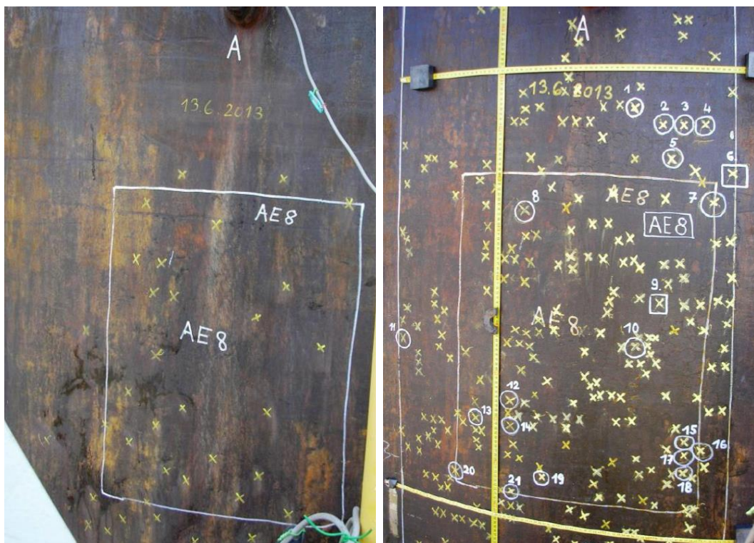
Obr. 8 Zjištěné indikace vad pomocí NDT na plášti reaktoru R 201 [63]
