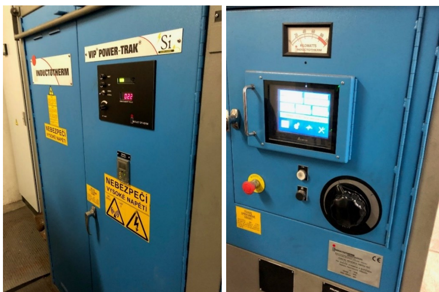
Obr. 50 Zdroj a řídící jednotka k indukční peci Inductotherm
