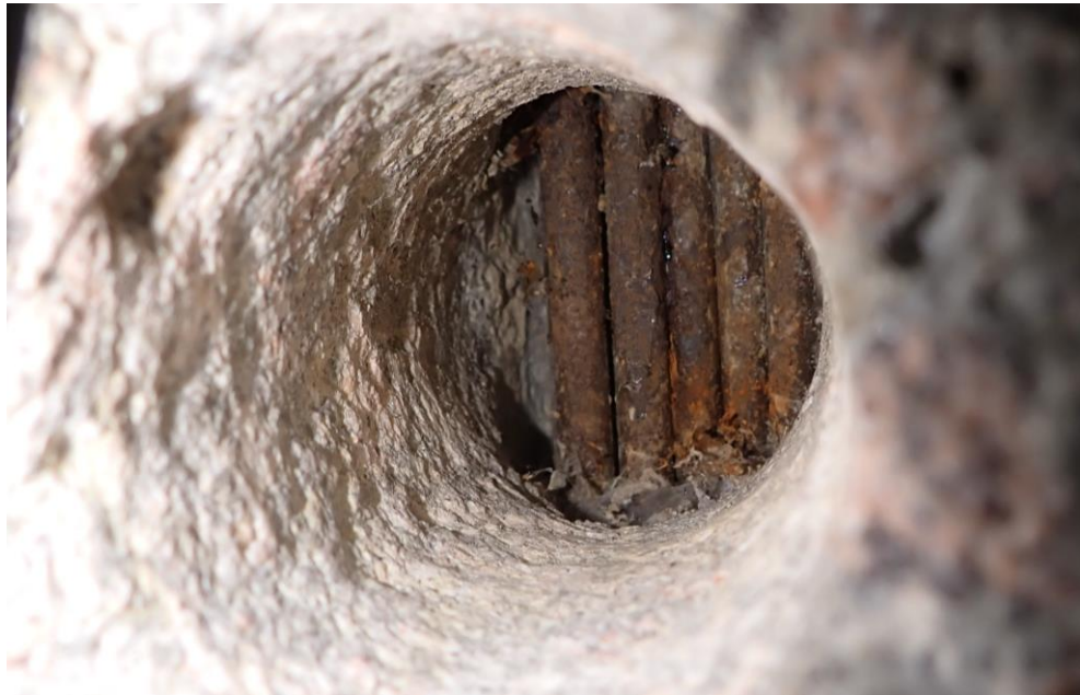
Obrázek 15: Dutina v injektážním kanálku a koroze předpínací výztuže [foto autora]
