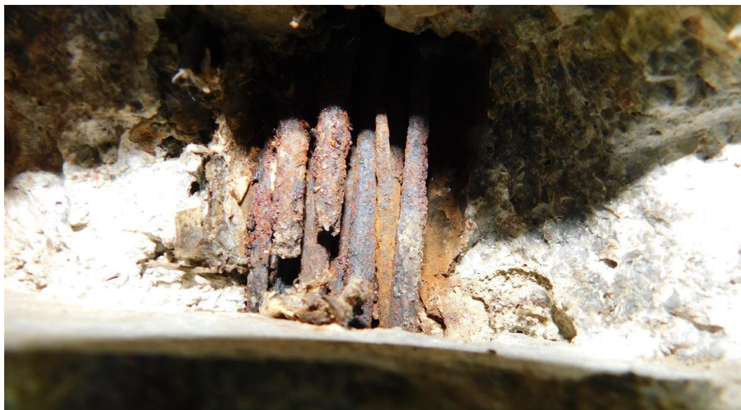
Obrázek 5: Koroze vedoucí k lomu předpínacích drátů [foto autora]
