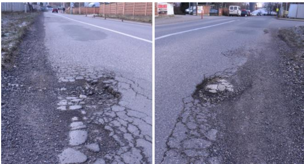
Obrázek 23 - výmoly v ulici Na Máchovně
