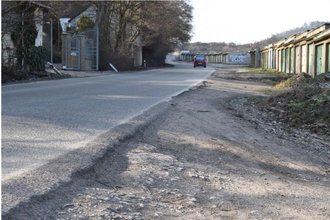
Obrázek 29 - negativní důsledky erozní činnosti vody v ulici Okrajová
