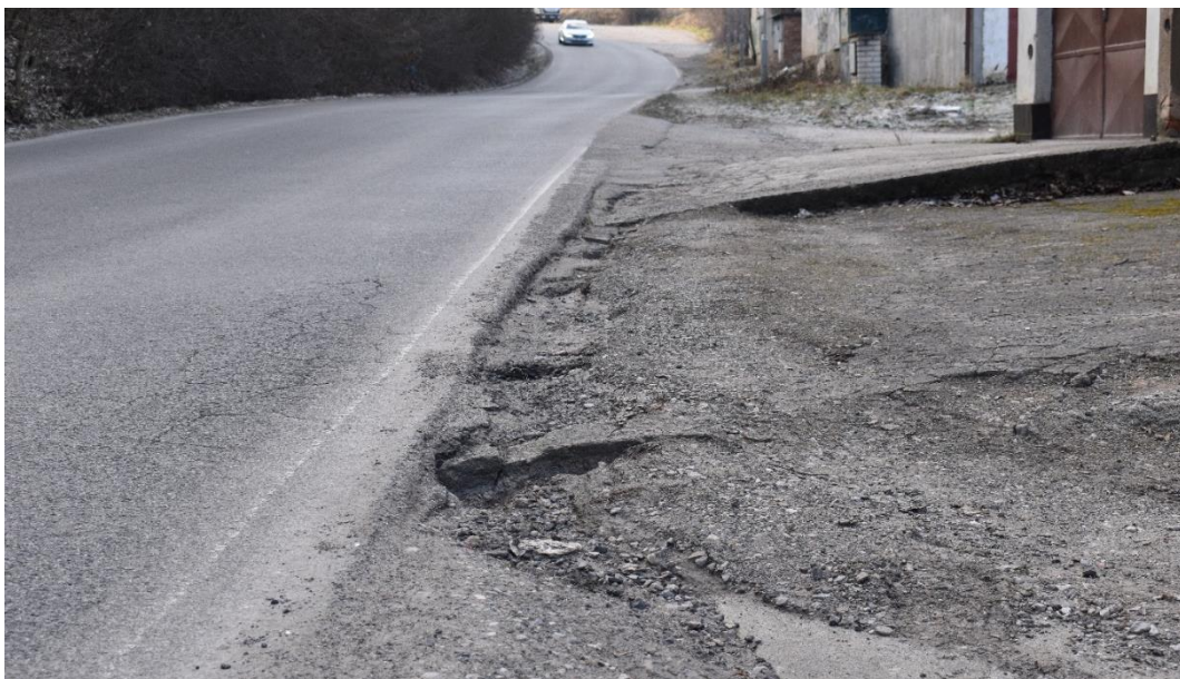
Obrázek 28 – negativní důsledky erozní činnosti vody v ulici Okrajová
