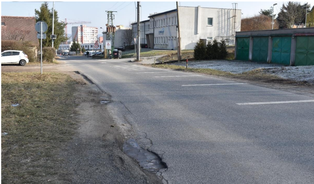
Obrázek 30 – poškozený povrch vozovky v ulici Okrajová
