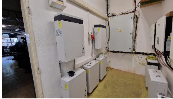
Obr. 105 Bateriové úložiště [Autor]
