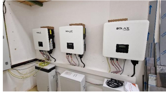
Obr. 106 Měniče solární elektrárny [Autor]
