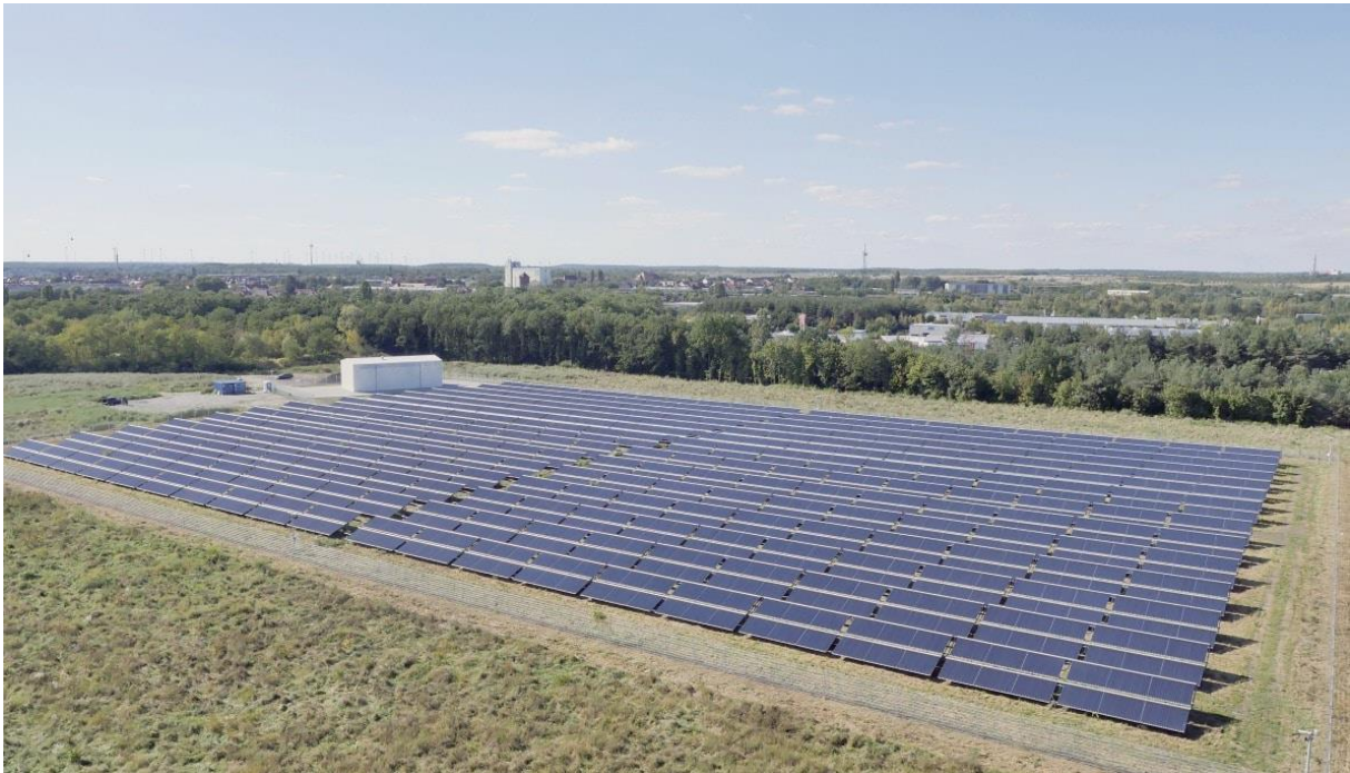
Obr. 2.8 – Pohled na kolektorové pole, Senftenberg [8]
