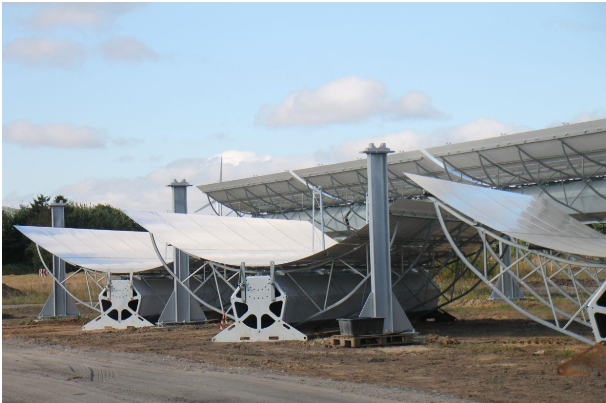
Obr. 4.18 – Parabolické panely instalované v CZT města Brønderslev [53]
