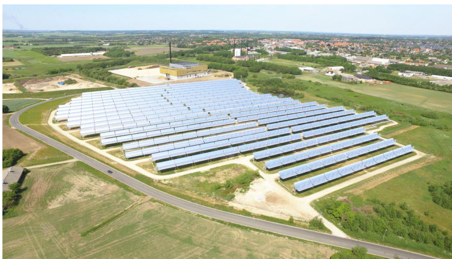
Obr. 4.16 – Pohled na kolektorové pole ve městě Brønderslev [1]
