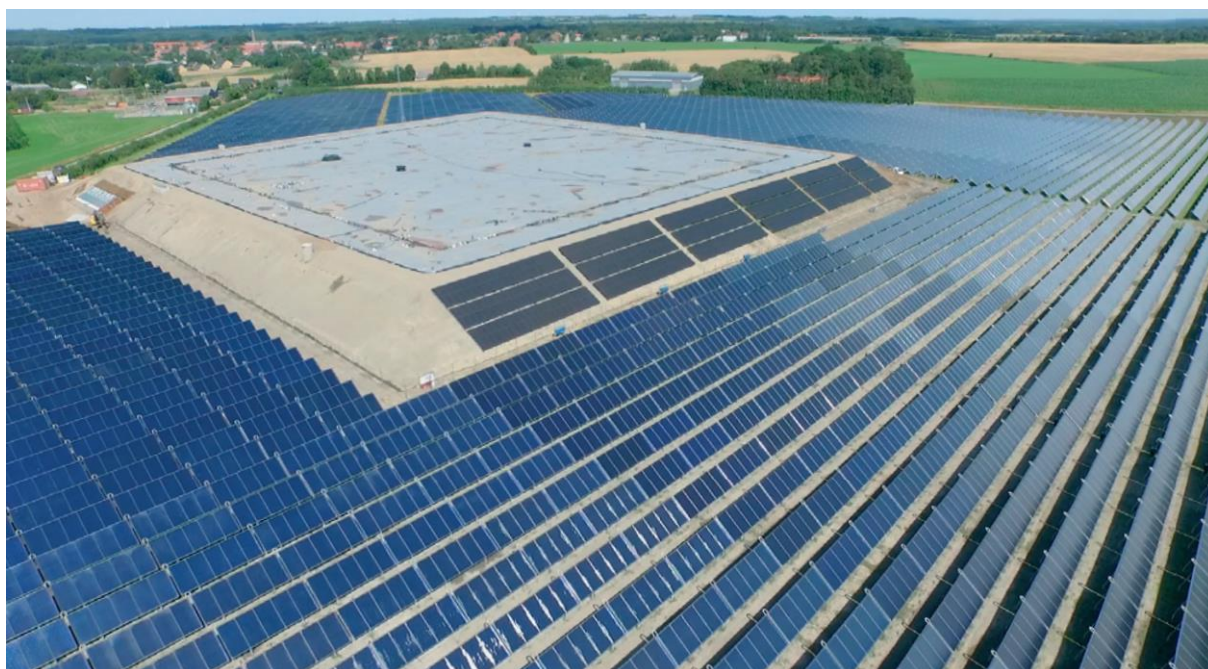
Obr. 4.7 – Pohled na kolektorové pole a sezónní zásobník tepla [43]
