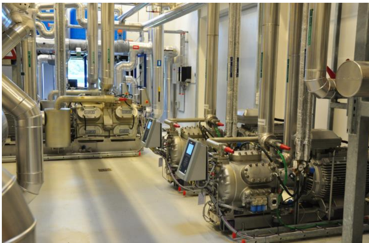
Obr. 3.12 – Tepelná čerpadla systému v obci Gammel Rye [33]
