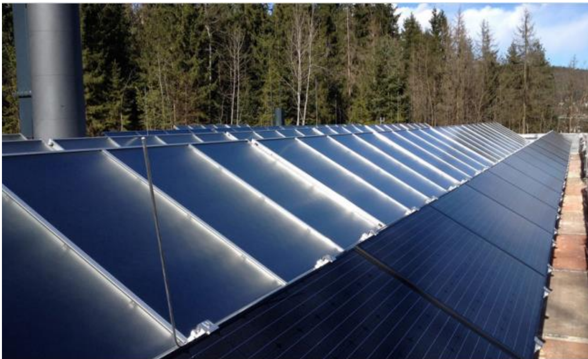
Obr. 3.15 – Kolektorové pole s tepelným čerpadlem u výtopny na biomasu [35]
