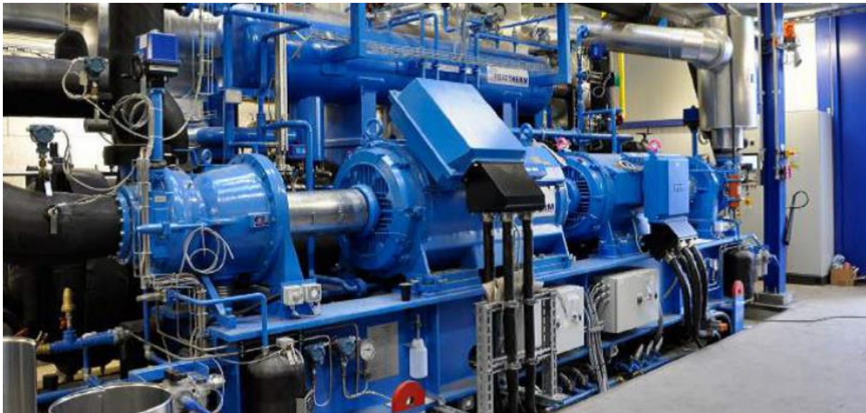
Obr. 3.7 – Tepelné čerpadlo v zařízení Marienhütte [30]
