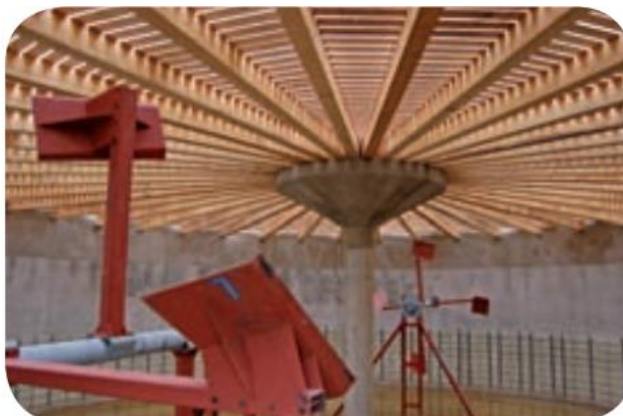
Obr. 26: Ochranný strop fermentoru z dřevěných trámů [13]
