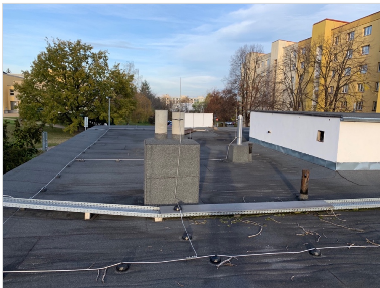
Obrázek 34 Překážky na střeše budovy Zdroj: Autor
