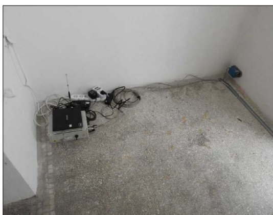
Obrázek 49: umístění monitorovací stanici a snímače č.2 v kostele (archiv firmy INSET)
