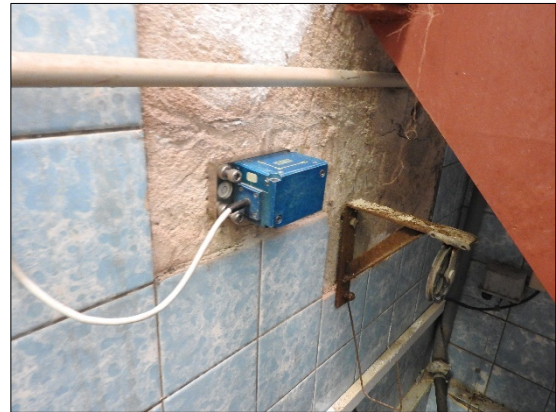
Obrázek 57: umístění snímače č.2 v objektu č. p. 76/68 (archiv firmy INSET)
