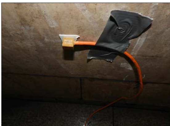
Obrázek 58: kontrolní měření na obkladech v metru stanice Jiřího z Poděbrad (archiv firmy INSET)
