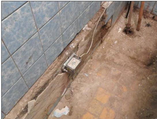
Obrázek 56: umístění snímače č.1 v objektu č. p. 76/68 (archiv firmy INSET)
