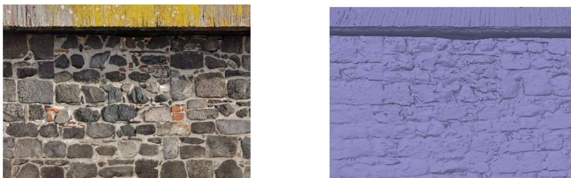
obr. č. 65, 66: ortofoto a 3D model bez textury v detailu, zazděné otvory věže, pohled od západu; vlastní zdroj
