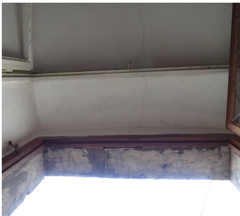
Obrázek 25 - Vyobrazení trhlin v nadpraží okna, východní stěna 3P
