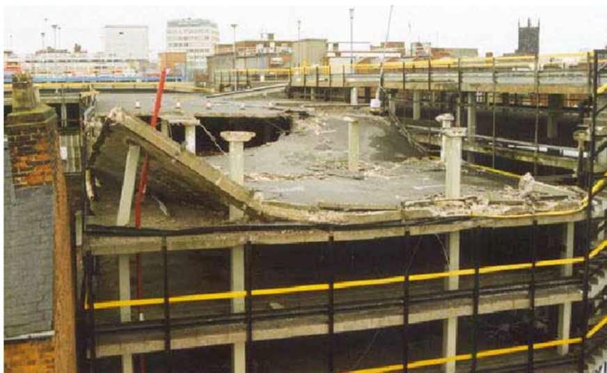
Obr.1 – kolaps lokálně podepřené desky (Pipers Row Car Park) [12]
