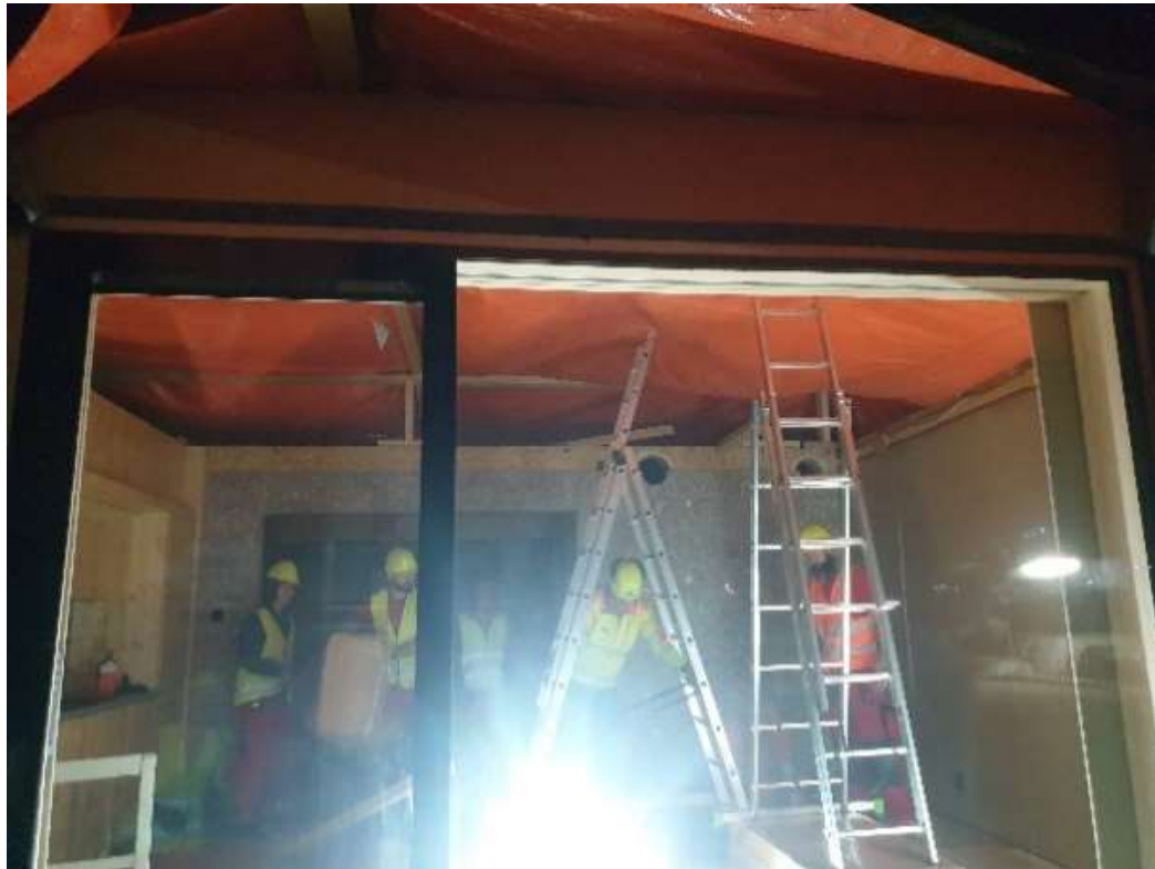
Obrázek 12: Provizorní konstrukce pro zadržení dešťové vody
