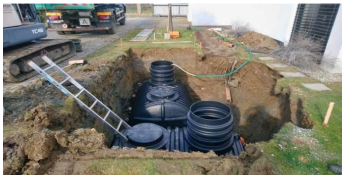
Obrázok 15 Akumulácia dažďových vôd, zdroj: https://www.robicont.cz/akumulace-destovych-vod/
