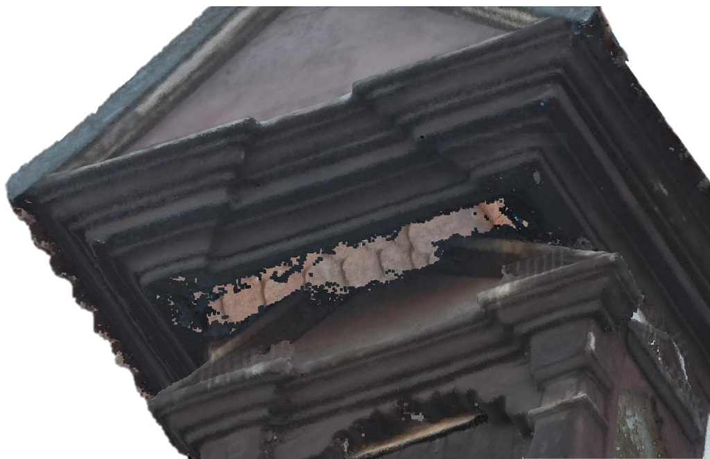
Obrázek 49: Chybějící části vyhotoveného mračna – č.p. 472
