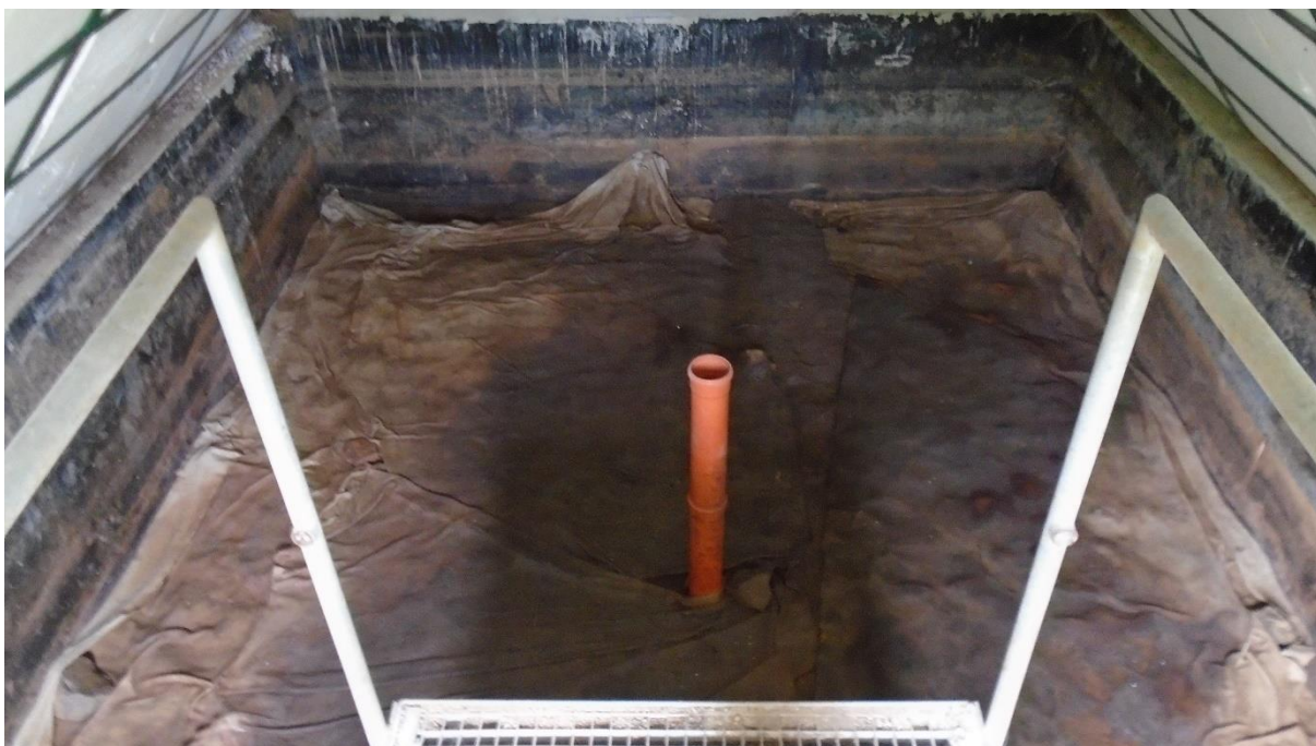
Obr. č. 32 – Vnitřní prostor pískového filtru s pokrytím geotextilií a odvětrávacím potrubím
