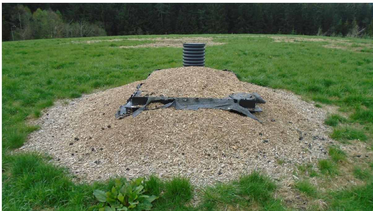
Obr. č. 23 – Kokso-kompostový filtr k přečištění skládkového plynu a jeho uvolnění do ovzduší
