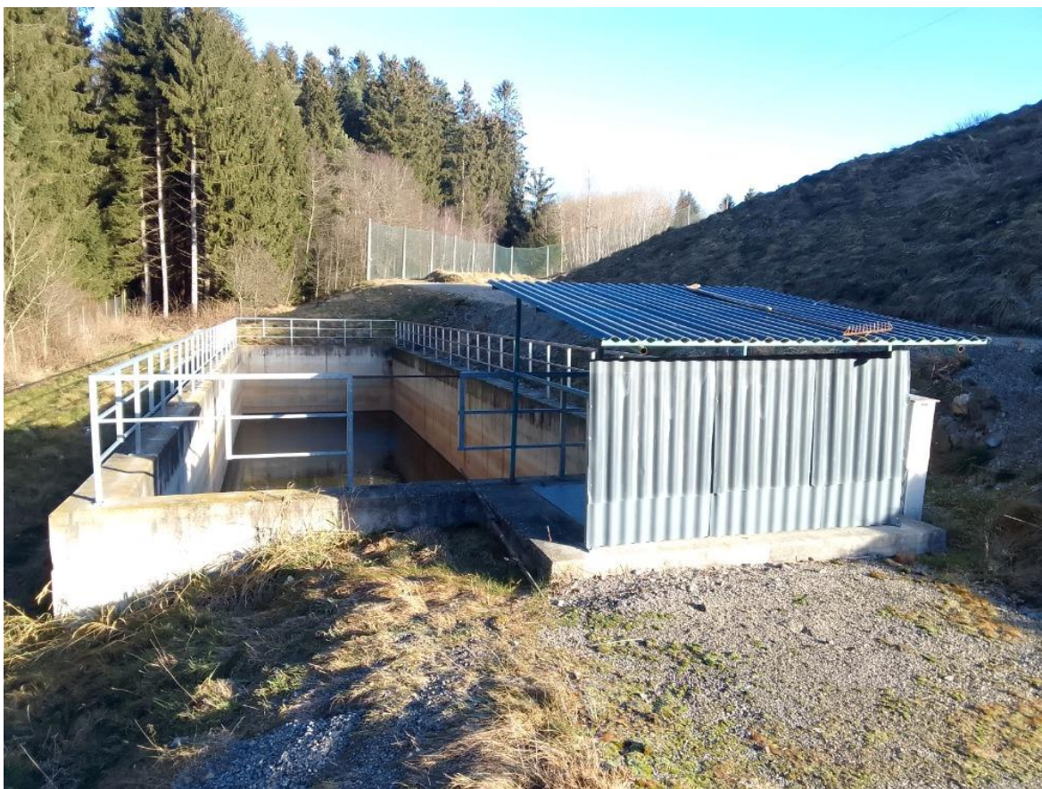
Obr. č. 21 – Bezodtoká jímka s objemem 500 m 3 pro akumulaci vod odtékajících z tělesa skládky
