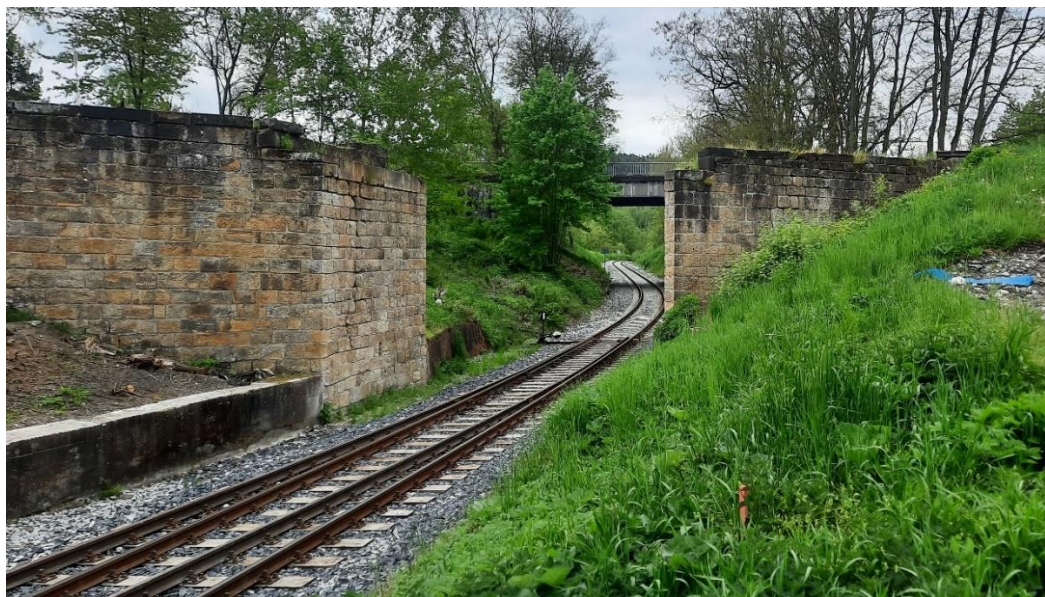
Obrázek 13 - Dva mostní objekty omezující vedení trati v obvodu ŽST Ústěč (snesená nosná konstrukce mostu bude opravena a vrácena do původní polohy)
