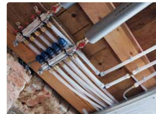
Připojení Uponor Renovis panelů nainstalovaných na stropě na rozdělovač. Zónová regulace místností za pomoci termopohonů a prostorových termostatů.
