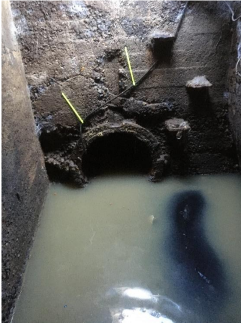
Obrázek 29: OK garáže – fotografie odtoku na ČOV [14]
