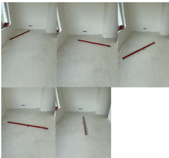
Obrázek 18: Ukázka průběhu měření rovinnosti plochy podkladu před pokládkou a po pokládce následuje stejný postup (vlastní)
