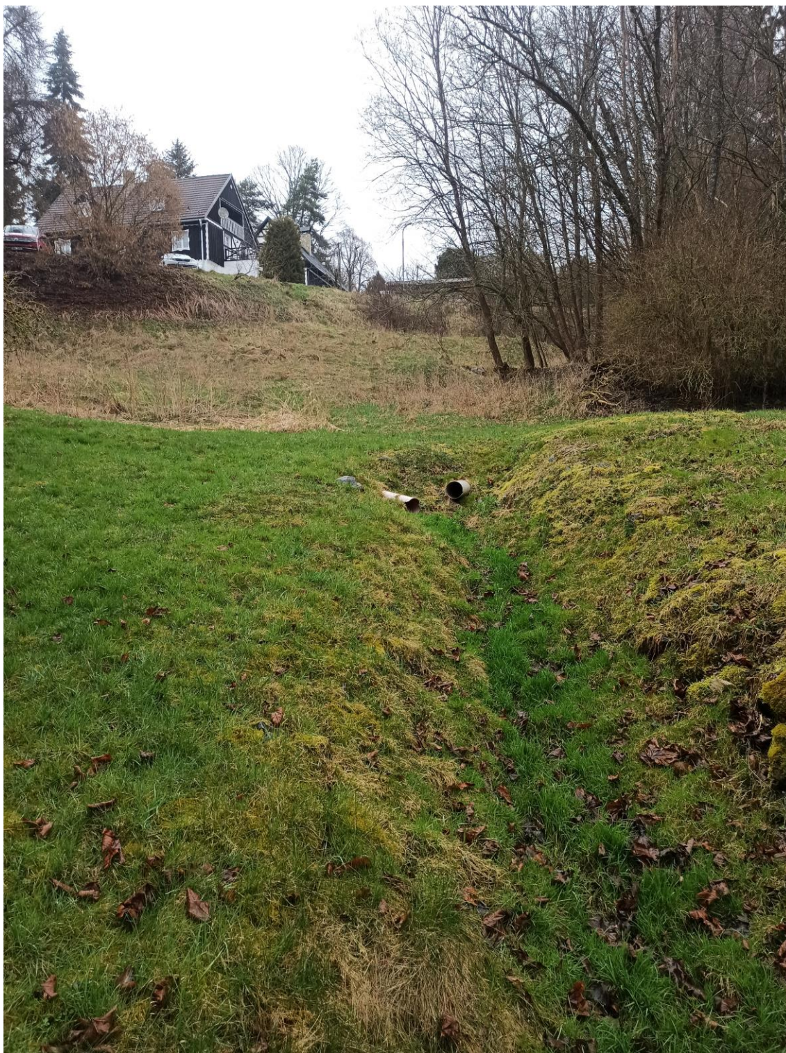
Obr. 31 – Příklad starého, načerno realizovaného svodného potrubí bez dokumentace
