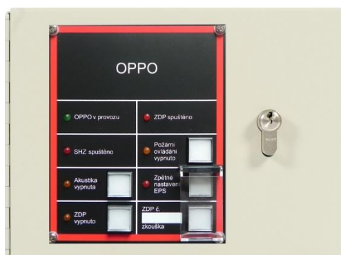
obr. 18- Obslužné pole požární ochrany [27]
