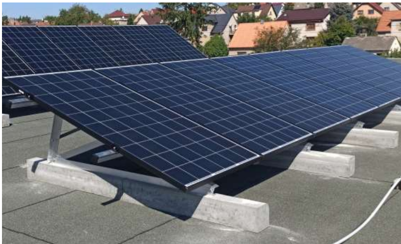
Obrázek 8: Fotovoltaika na ploché střeše Benešov převzato z [15]
