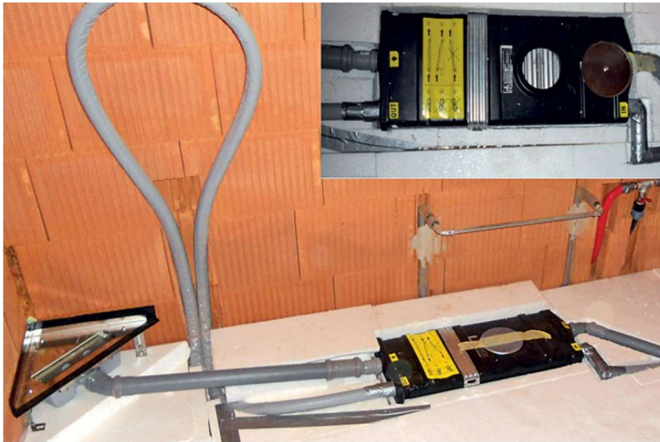
Obrázek 13 - Podlahový výměník tepla
