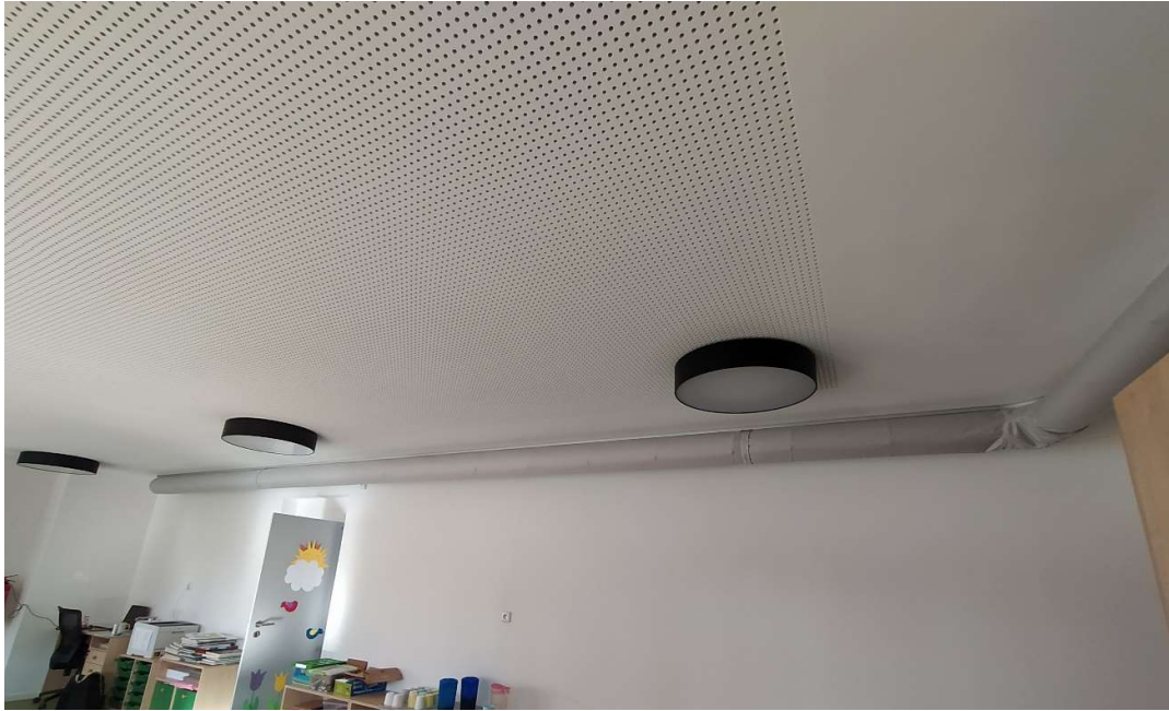
Obrázek 7: Distribuční prvek vzduchotechniky v učebně
