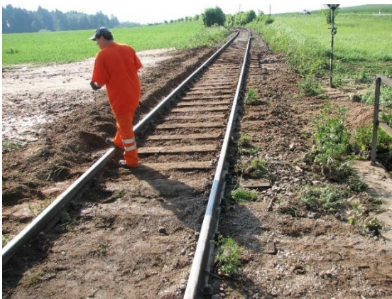
Obrázek 4: zanesená kolej sedimentem, událost Rovné 2008, archiv Městského úřadu Bystřice nad Perštejnem
