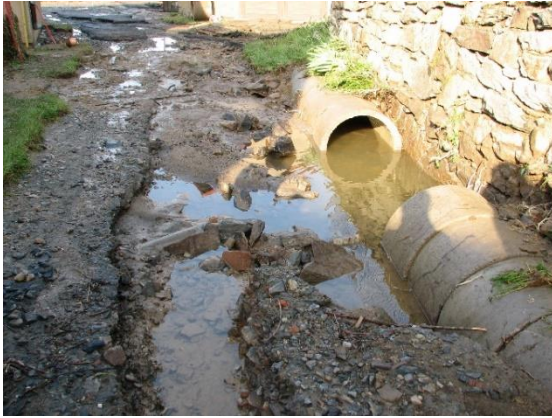
Obrázek 6: poničená dešťová kanalizace, událost Rovné 2008, archiv Městského úřadu Bystřice nad Pernštejnem
