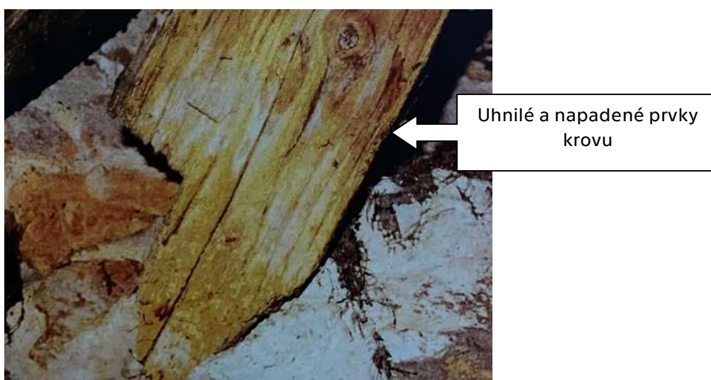
Obrázek 48: Degradace dřevěných prvků krovu [archiv]
