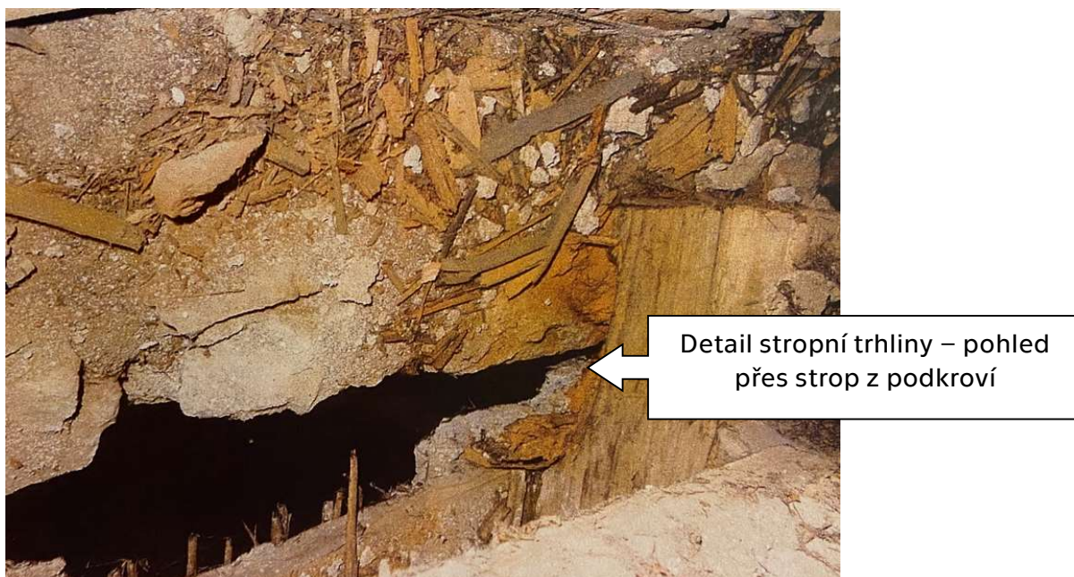
Obrázek 44: Degradace stropní konstrukce [archiv]
