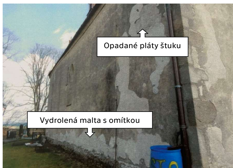
Obrázek 39: Degradace obvodového zdiva – exteriér
