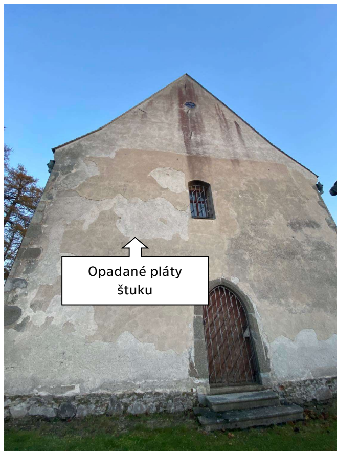
Obrázek 40: Degradace obvodového zdiva – exteriér
