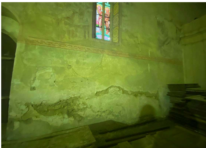
Obrázek 41: Degradace obvodového zdiva – interiér (jižní stěna)
