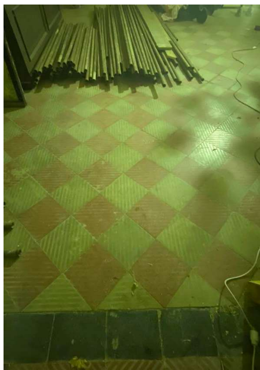
Obrázek 50: Povrchové opotřebení cementové dlažby
