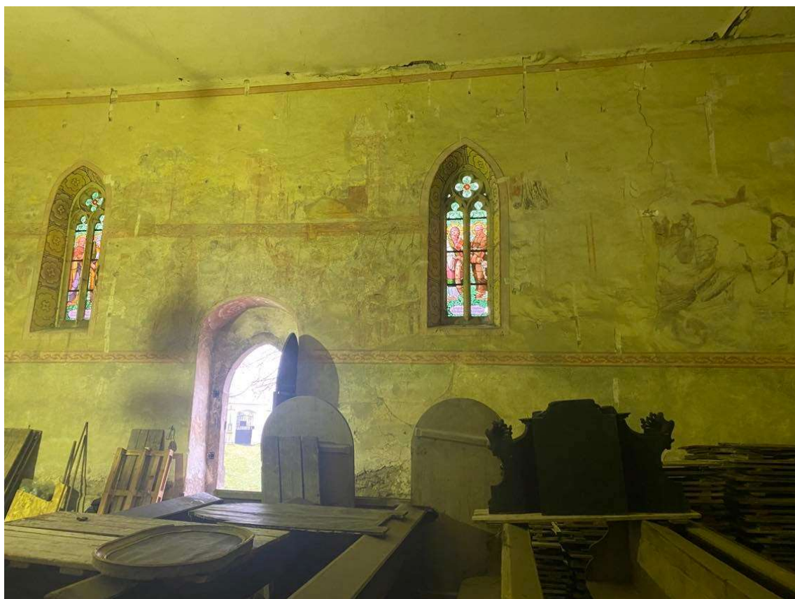
Obrázek 53: Degradace vnitřní omítky – značné poškození vnitřních maleb
