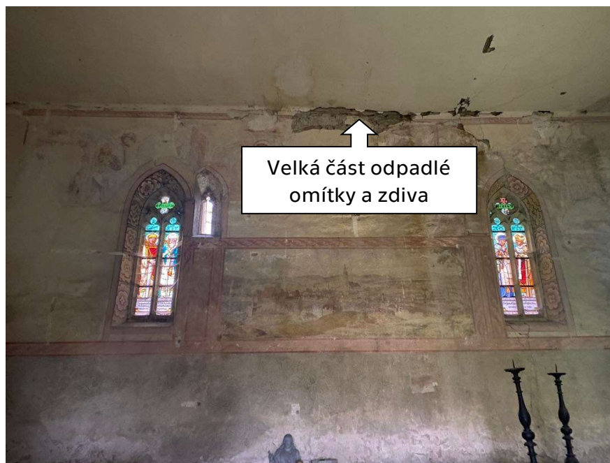
Obrázek 42: Pohled na severní stěnu – degradace v oblasti stropu
