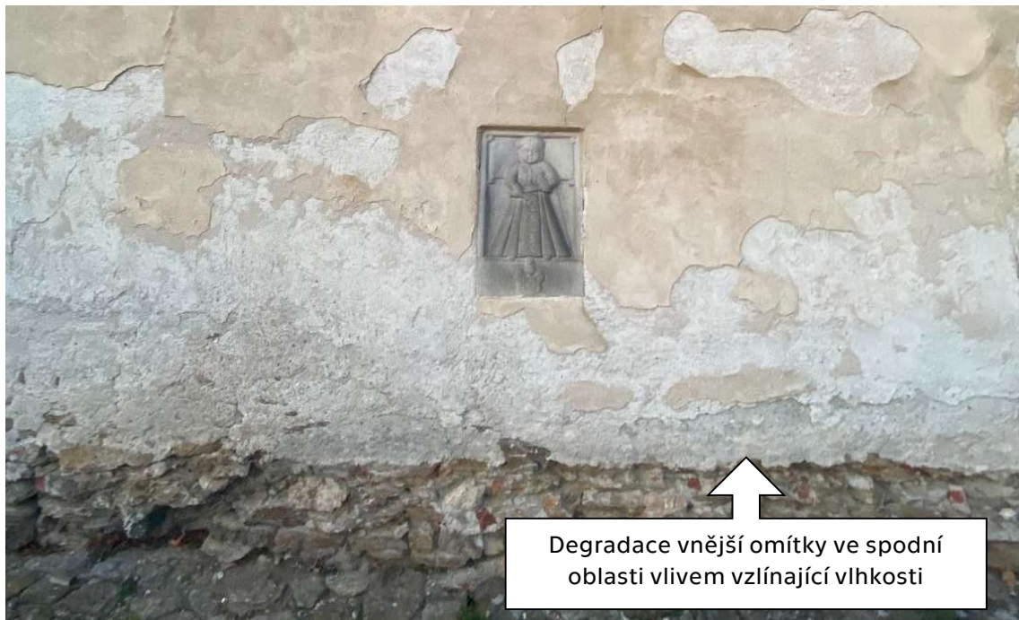
Obrázek 52: Degradace vnější omítky
