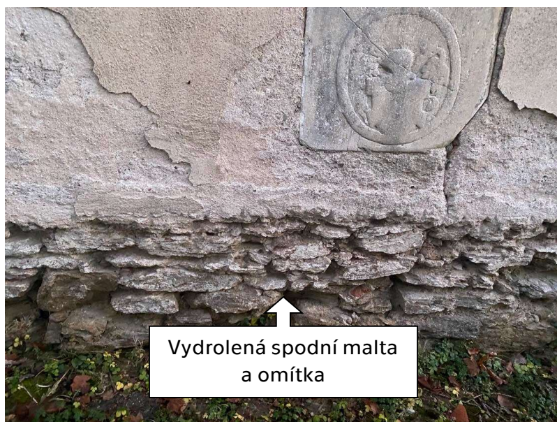
Obrázek 38: Degradace v oblasti soklu – zvýšená vlhkost
