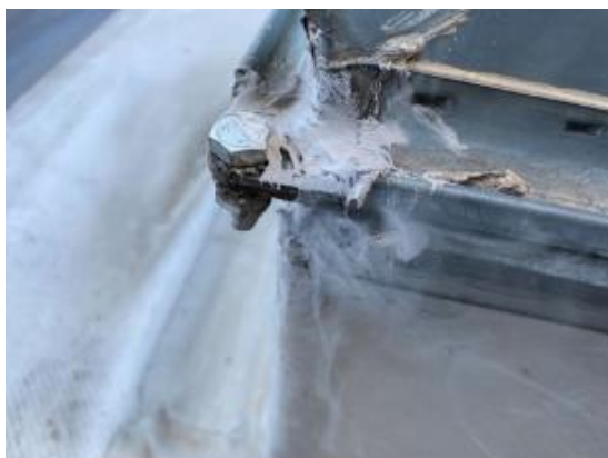
Obr. 63 - Netěsnost VZT bloků (foto autor)
