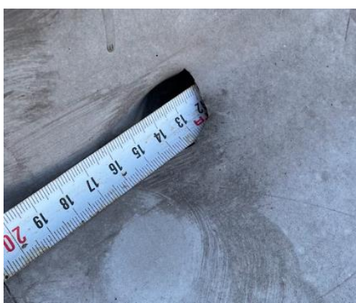
Obr. 59 - Porucha v ploše (foto autor)
