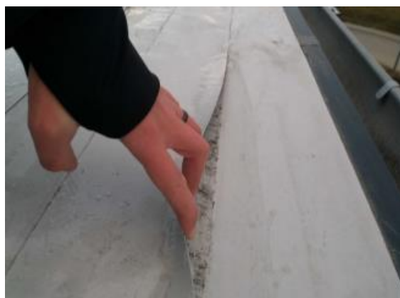
Obr. 82 - Nesoudržné provedení sváru
