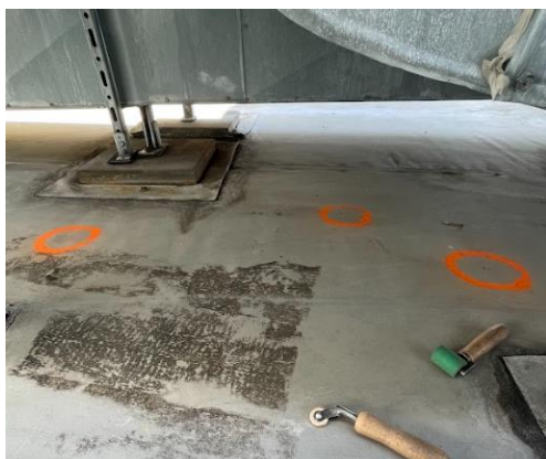
Obr. 61 - Označení nalezených defektů (foto autor)
