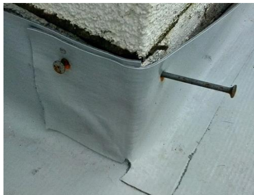
Obr. 8 – Příklad nevhodného ukončení [15]
