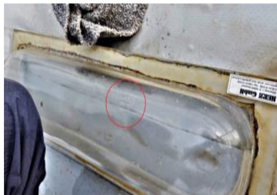
Obr. 78 - Nález při provedené zkoušce
