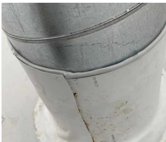
Obr. 68 - Absence nerezové pásky na prostupu (foto autor)
