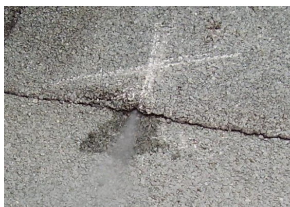
Obr. 56 - Defekt odhalený pomocí dýmové zkoušky (foto autor)
