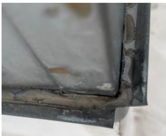
Obr. 69 - Degradace tmelené spáry [64]
