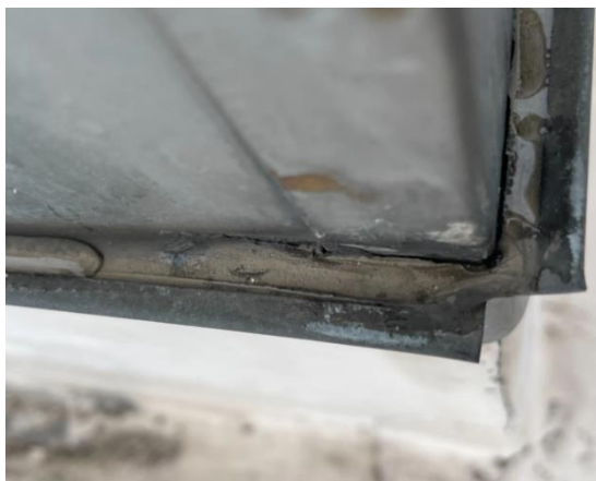
Obr. 51 - Příklad degradace tmelu [64]
