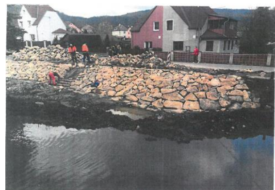
Obrázek 35 – Rybník u Zámku, opevnění levého břehu 21.4.2017 zdroj: PD Fotodokumentace [16]
