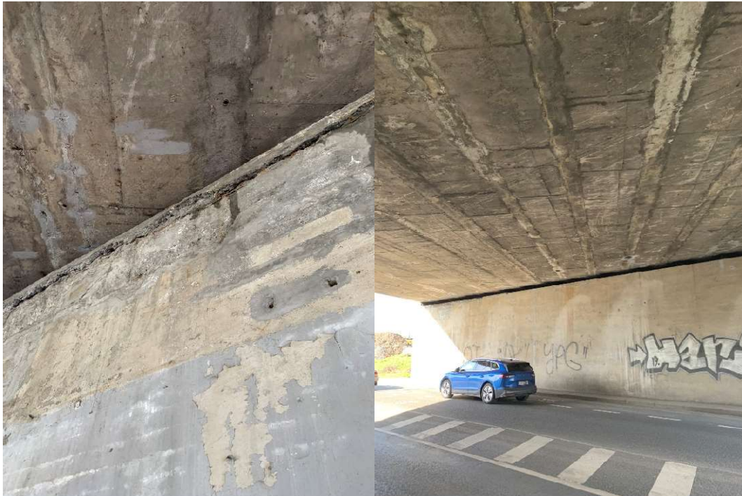
Obrázek 2-14 Značně poškozený povrch opěry a nosníků (vlevo)
