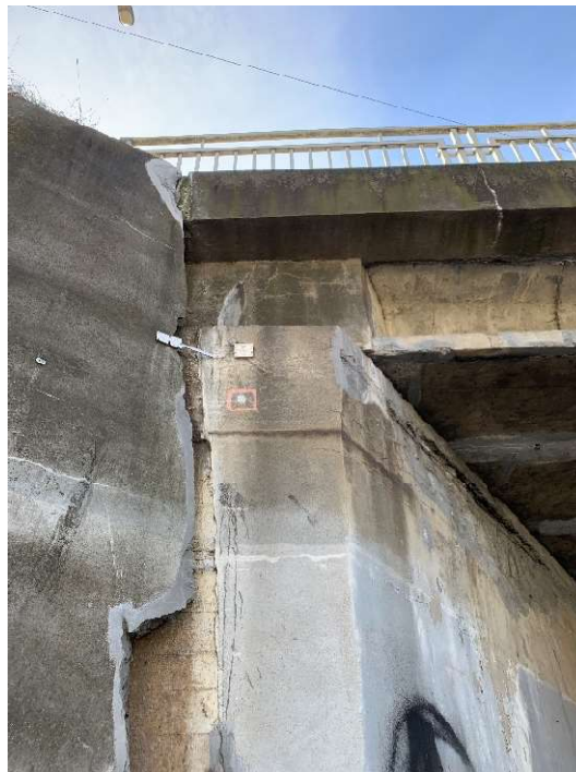
Obrázek 2-16 Zařízení na levém křídle opěry pro měření posunu
