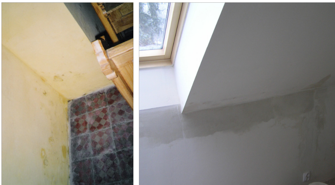
Obr. 1.2. Kondenzace vodní páry na stěnách: vlevo objekt s vysokou tepelnou setrvačností, vpravo povrchová kondenzace v místě tepelného mostu (Solař, 2009)
