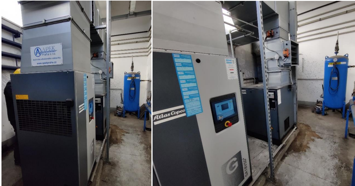
Obrázek 16: pohled na kompresorovnu
