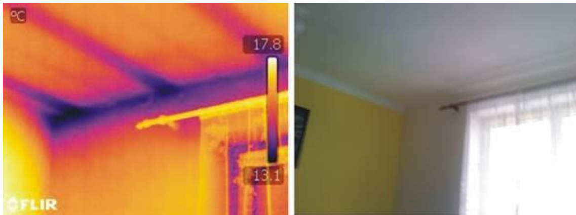
Obr. 2 Termogram přechodu stěny so stropní konstrukce na vnitřní straně [O2]
