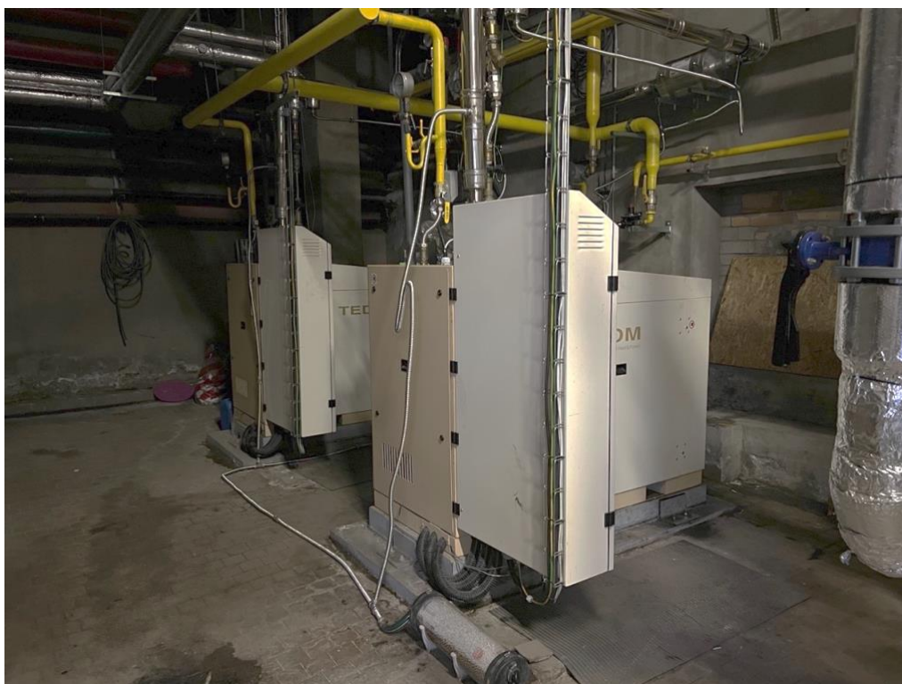
Obrázek 6-3: Kogenerační jednotky v kotelně penzionu Chmelnice
