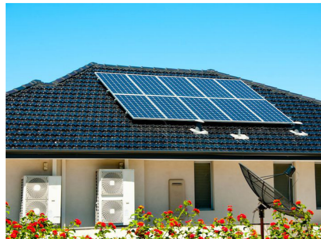
Obrázek 45 Příklad aplikace tepelného čerpadla a fotovoltaických panelů (Woltair.cz)
