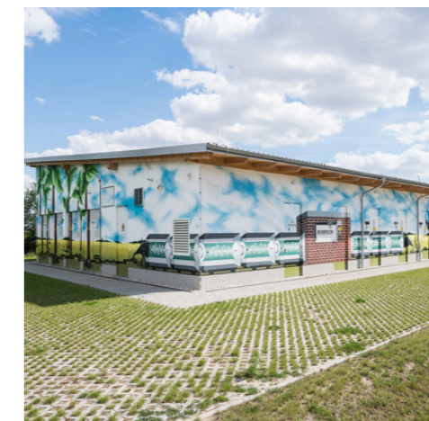
Obrázek 53 Bateriové úložiště (zdroj: nef-feldheim.info)
