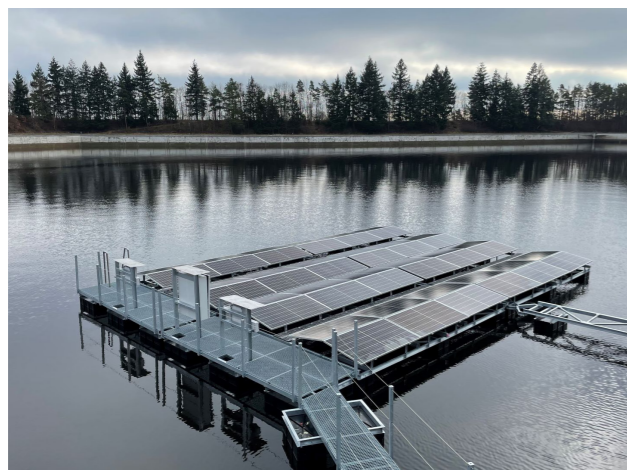
Obrázek 22 První plovoucí fotovoltaická elektrárna v České republice instalovaná skupinou ČEZ (zdroj: ČEZ)
