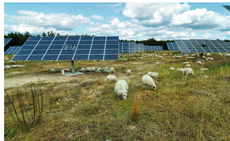
Obrázek 52 Solární elektrárna v bývalém vojenském prostoru (zdroj: nef-feldheim.info)
