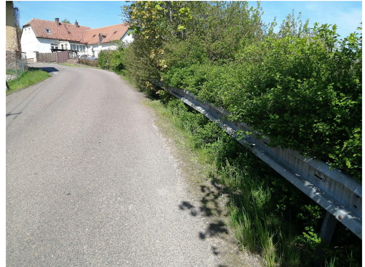
Obrázek 29: Úsek silnice III/35816 s chybějícím chodníkem
