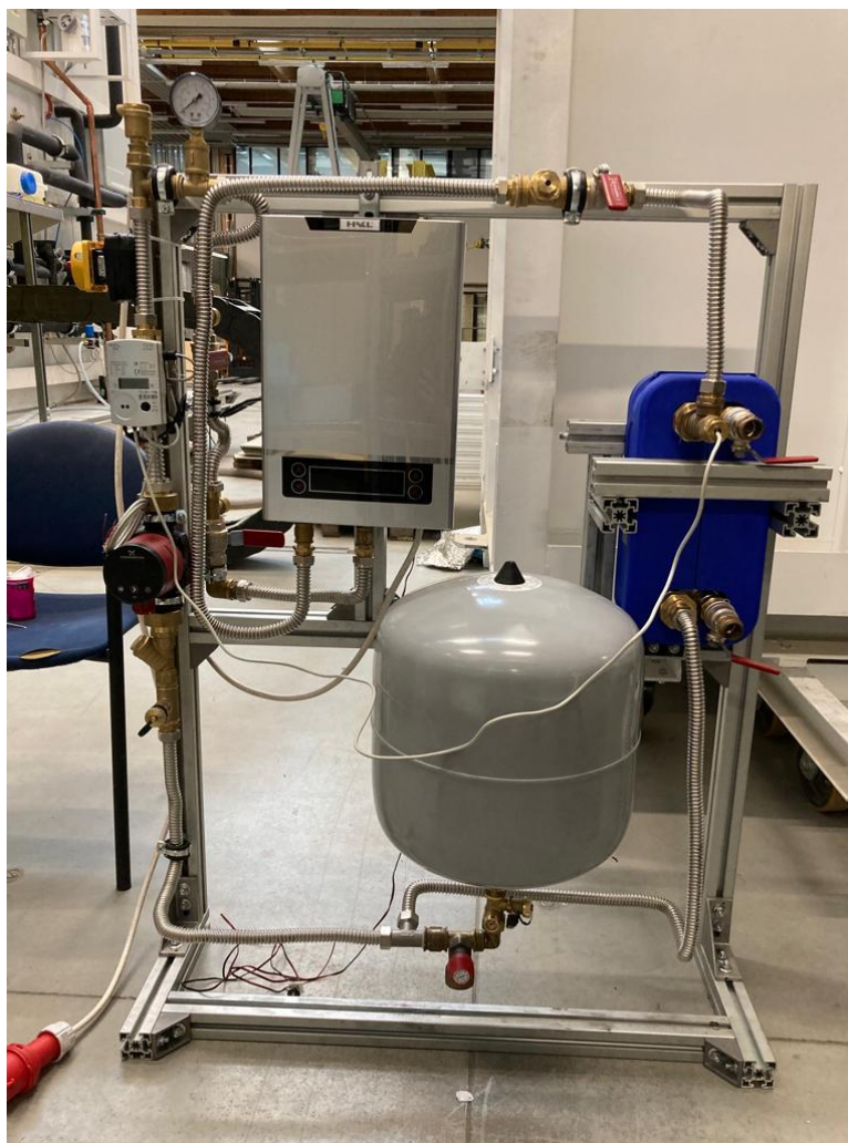
obr. 76: sestavený vodní okruh elektrokotle
