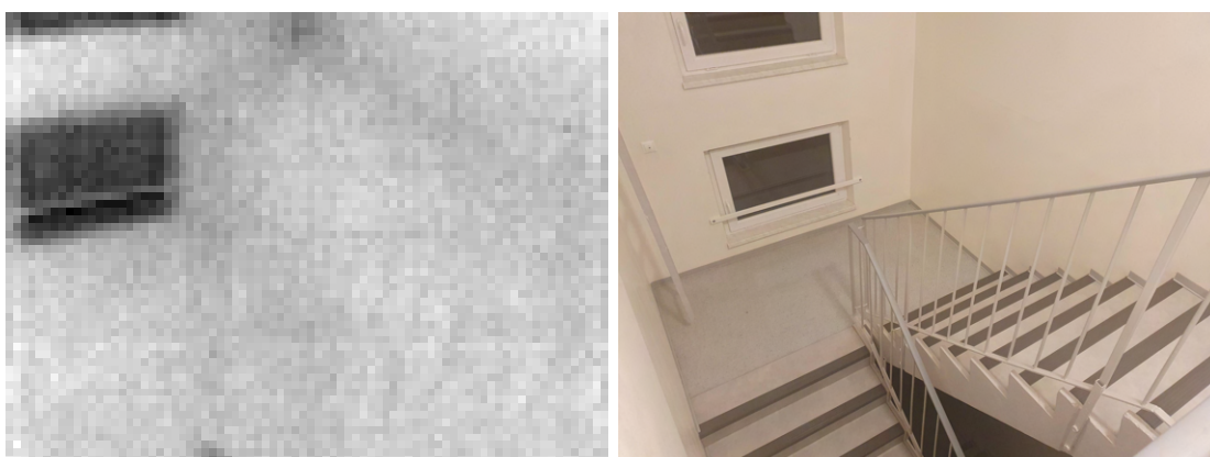
(a) : Snímek pořízený termokamerou
